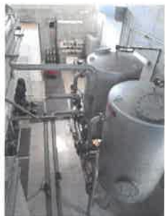
Usine à filtration de La Boissière, patrimoine repris en Régie dès le 1er janvier 2022
